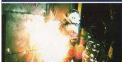
сварочные работы, окурки
